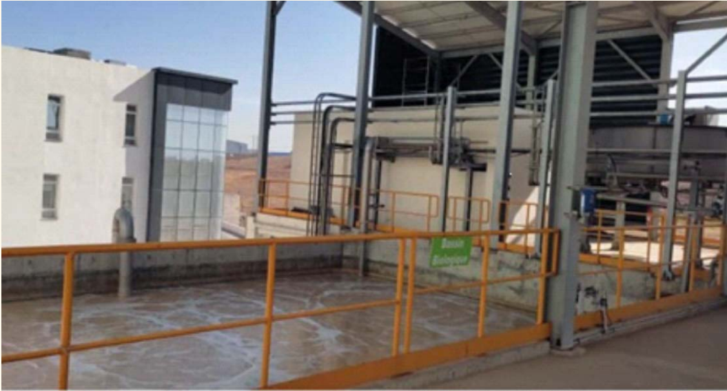
Hình ảnh xử lý nước thải của nhà máy giấy tissue tại Faderco ở Algeria
